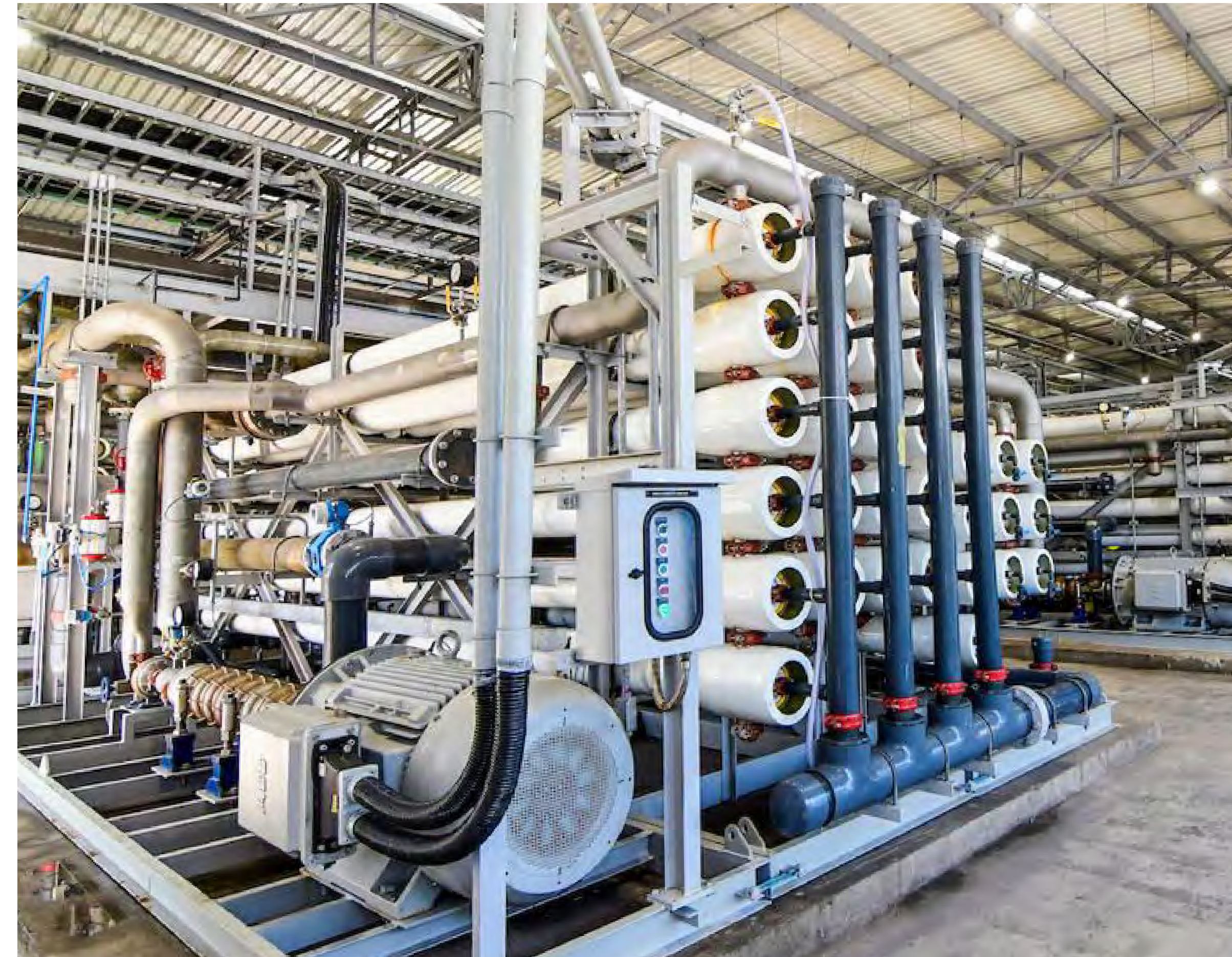
Planta de Dessalinização localizada na unidade de Tubarão, no Espírito Santo, faz parte do Plano Diretor de Águas
