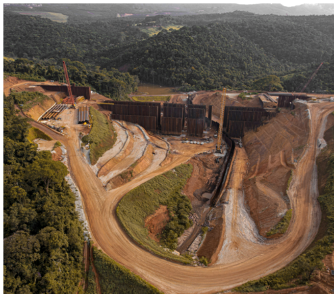
A ECJ é uma barreira que está sendo construída para reter 100% dos rejeitos em um cenário hipotético de ruptura da Barragem Serra Azul
