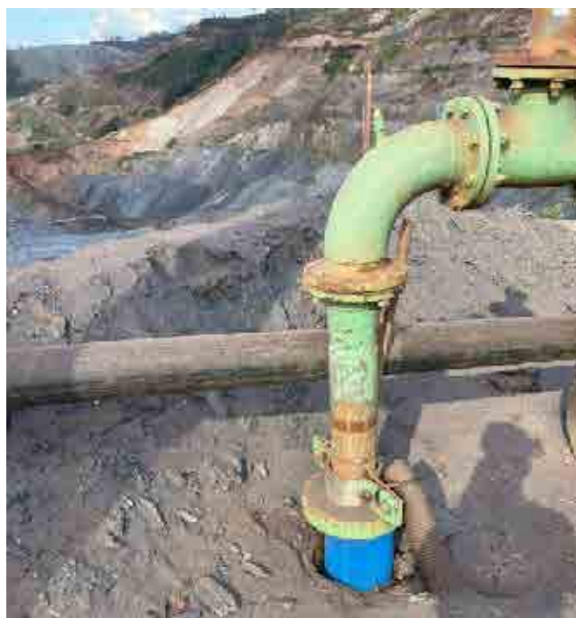
Figura 87 - Poço Tubular 04 - Portaria 1108047/2022
