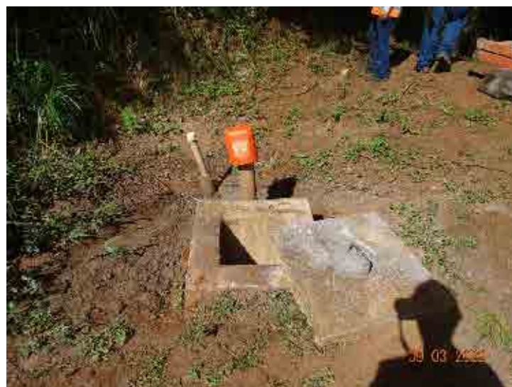
Figura 78 – Sistema Fossa Filtro Sumidouro da portaria do Paiol de explosivos
