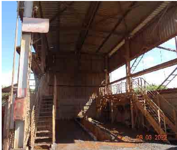
Figura 58 - Lavador de veículos/equipamentos
