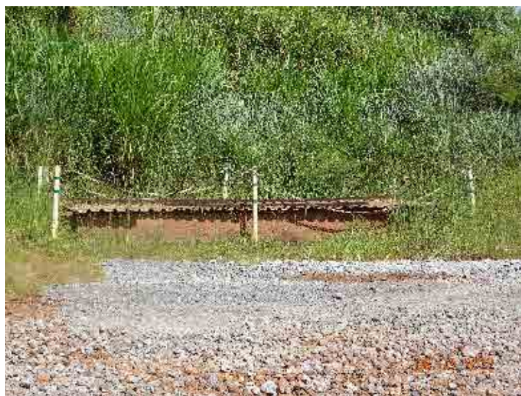
Figura 68 - Caixa Separadora de Água e Óleo
