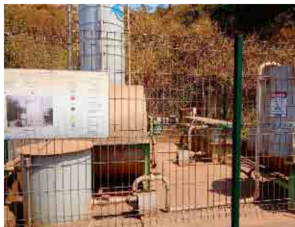
Figura 75 - Estação de Tratamento de Efluente da Área Embarque
