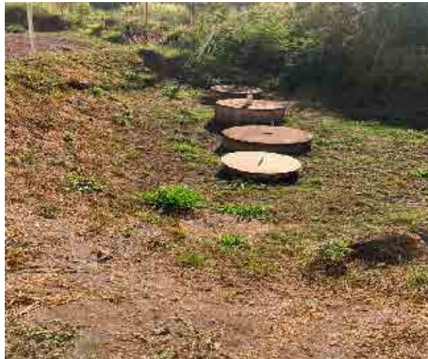
Figura 81 - Sistema Fossa Filtro Sumidouro do Posto de Combustível
