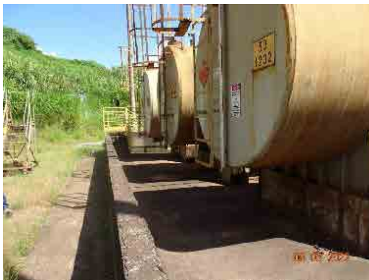
Figura 65 – 3 Tanques de diesel aéreos com capacidade de 30.000 litros cada
