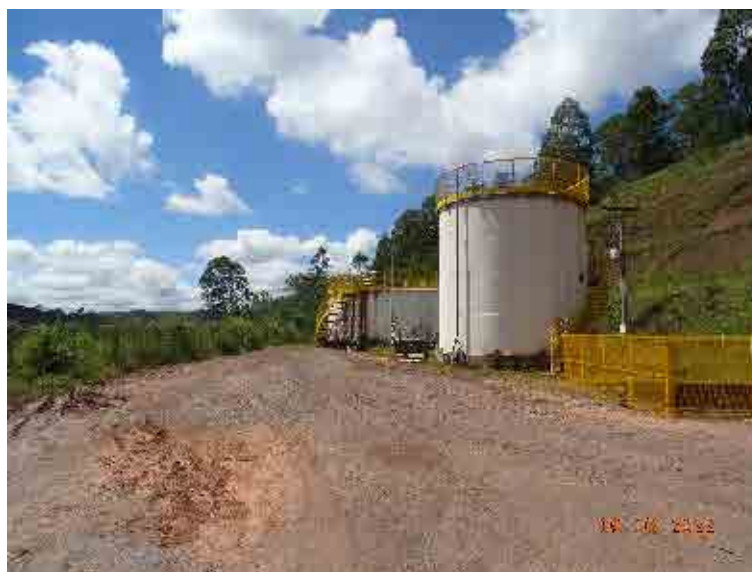
Figura 89 - Estação de Tratamento de Água - ETA
