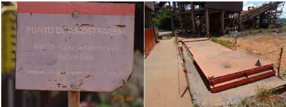
Figura 83 - Caixa separadora água e óleo oficina da mineração
