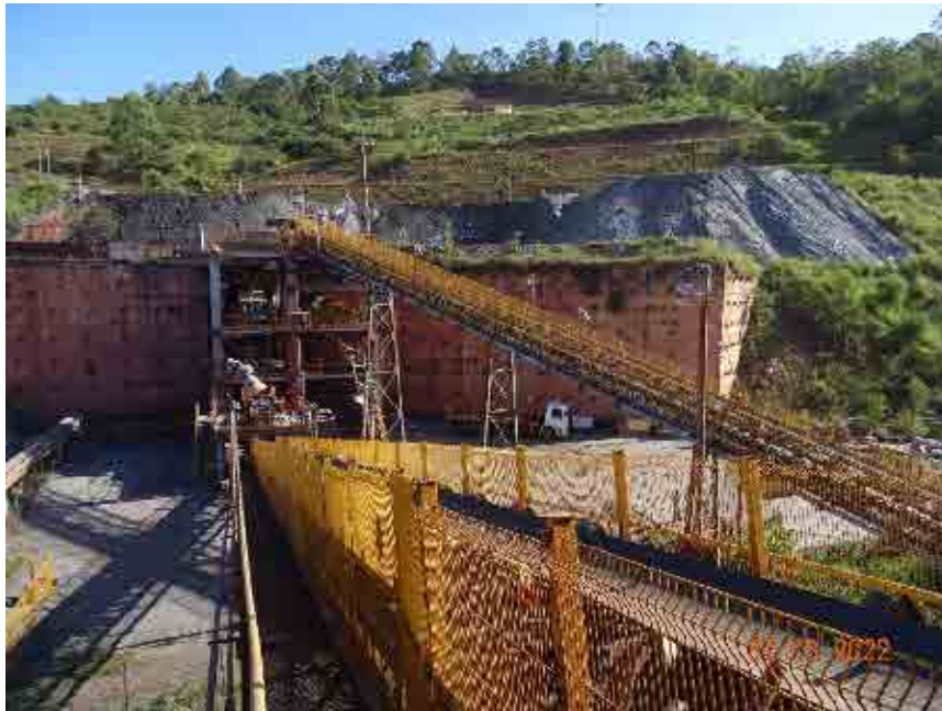
Figura 17 - Vista para o transporte do minério do britador primário para o secundário.
