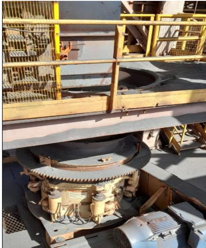
Figura 22 - Sistema de Britagem Terciária
