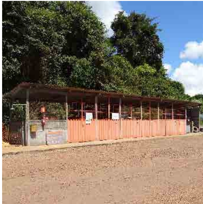
Figura 71 - Box coberto, com piso impermeabilizado e bacia de contenção
