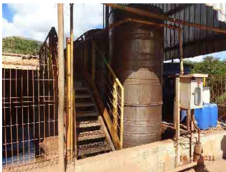
Figura 60 - Estação de Tratamento e Recirculação de efluentes oleosos.
