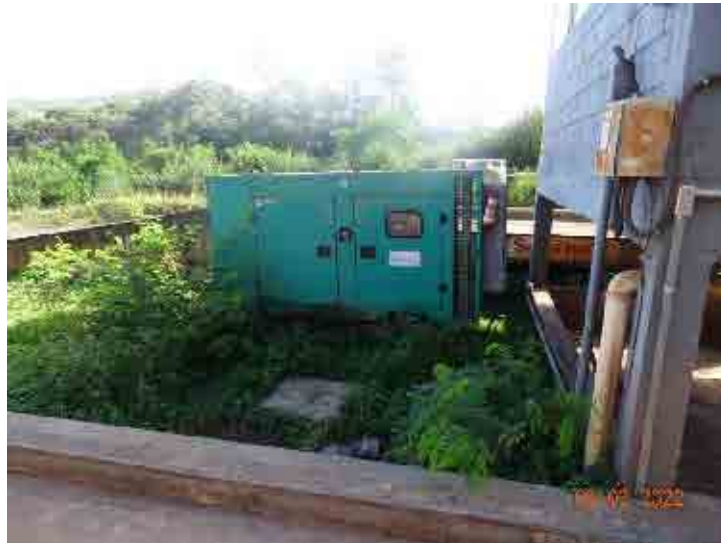
Figura 77 – Sistema Fossa Filtro Sumidouro da portaria de 3 Antas
