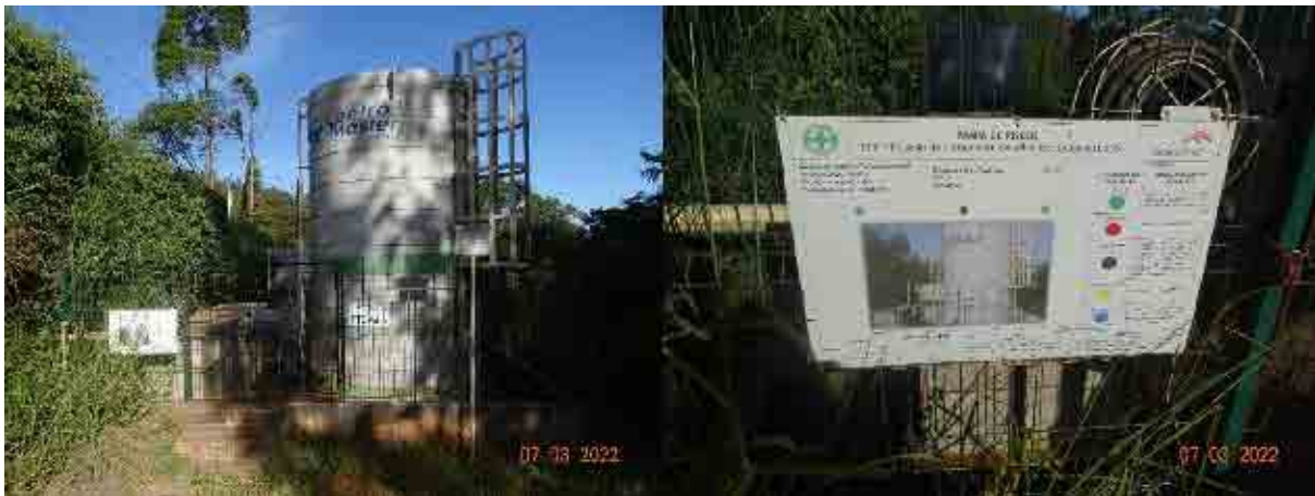
Figura 74 - Estação de Tratamento de Efluente da Área Administrativa/Restaurante
