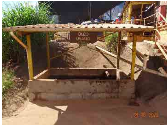
Figura 61 - Tanque de armazenamento de óleo usado
