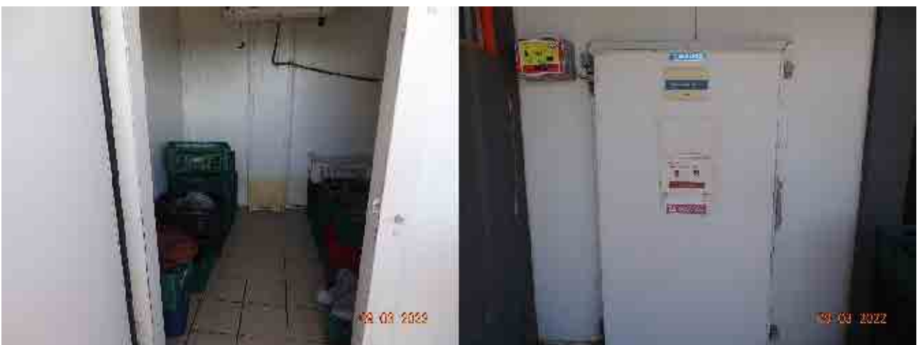
Figura 46 - Vista para Câmara Fria destinada aos resíduos orgânicos do Restaurante.
