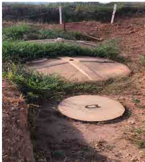
Figura 82 - Sistema Fossa Filtro Sumidouro do Galpão Testemunho
