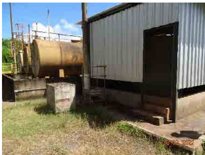
Figura 66 - Área de armazenamento de Arla
