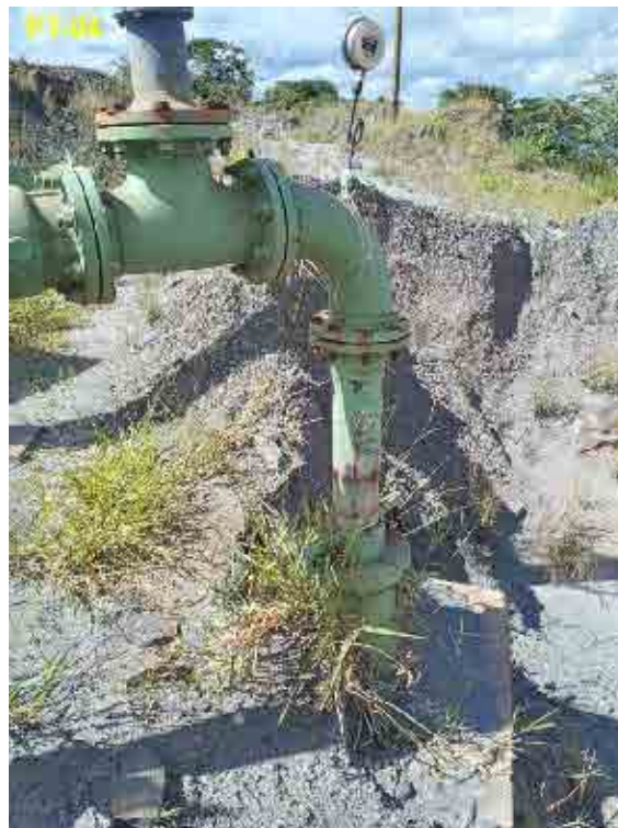
Figura 43 - Ponto de Monitoramento – Poço Tubular -04
