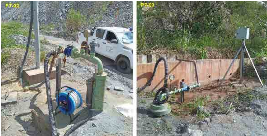
Figura 42 - Ponto de Monitoramento – Poço Tubular - 02 e 03.
