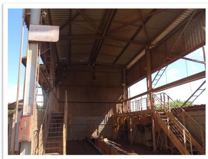
Figura 22 - Lavador de veículos pesados e leves
