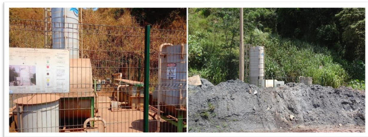
Figura 28 - Estação de Tratamento de Efluente da Área Embarque
