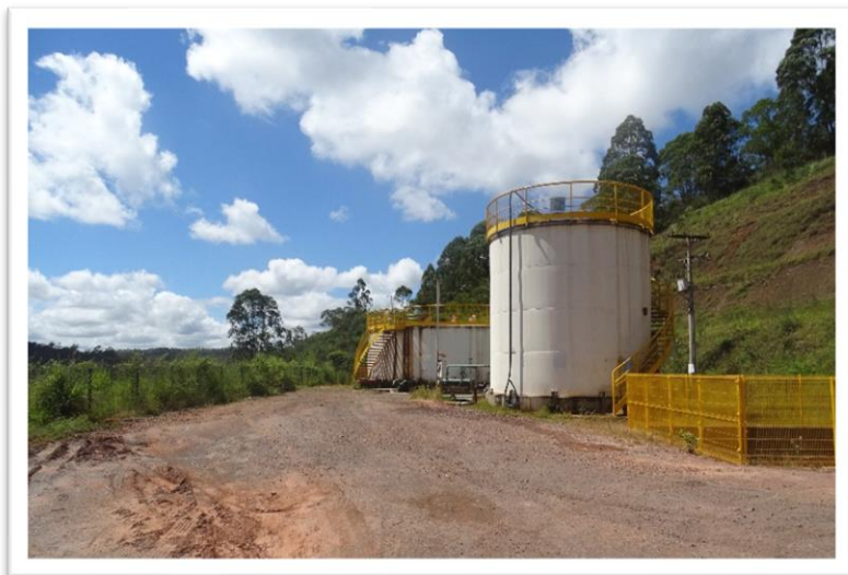
Figura 38 - Estação de Tratamento de Água - ETA
