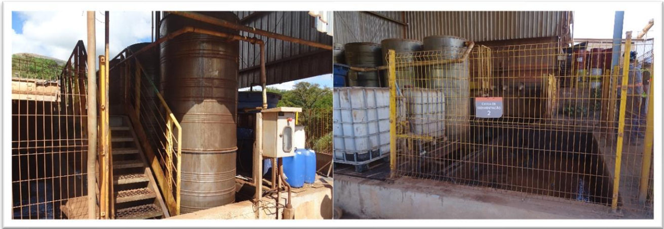
Figura 35 - Caixa SAO com recirculação e tratamento de efluentes oleosos.
