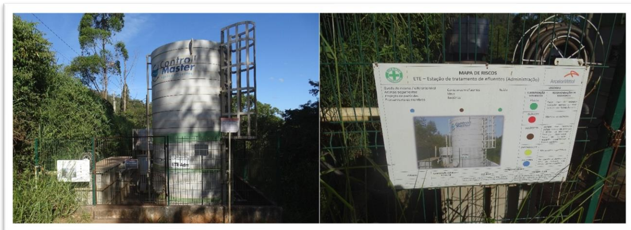
Figura 27 - Estação de Tratamento de Efluente da Área Administrativa/Restaurante.
