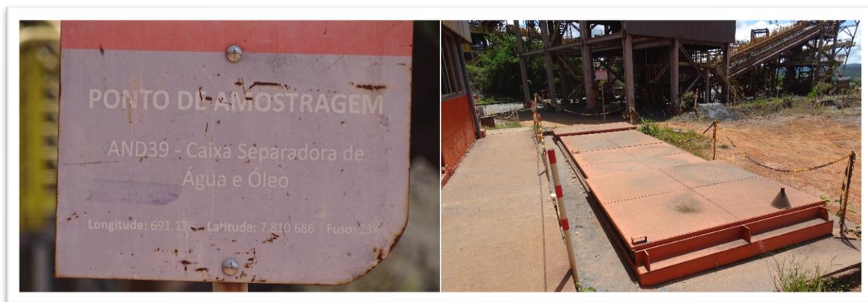
Figura 33 - Caixa separadora água e óleo oficina da mineração
